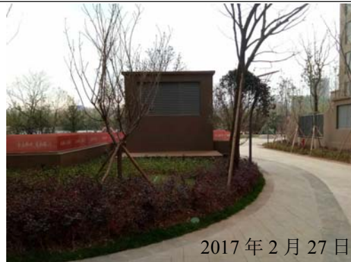
地下车库排气口
